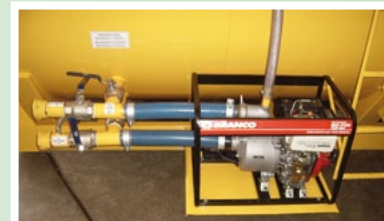
→ Acionamento por motobomba
